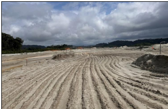
Fotografía 46. Líneas realizadas para facilitar el drenaje de agua en la superficie de los diques de la IMR.
