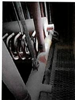
Foto de la parada de mantenimiento de la Unidad 1 – año 2019
