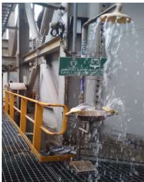
Ilustración 9 Inspección de ducha y lava ojos
