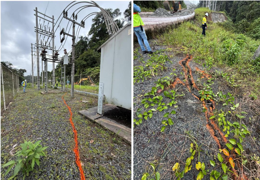
Inspección de campo del 3 de enero de 2026. Aparición de grieta en tensión en sub Estación, en camino hacia Poza 12. Se realizaron trabajos de desconexión de cableado y se sugiere reubicar sub Estación, debido al riesgo de colapso de la estructura.
