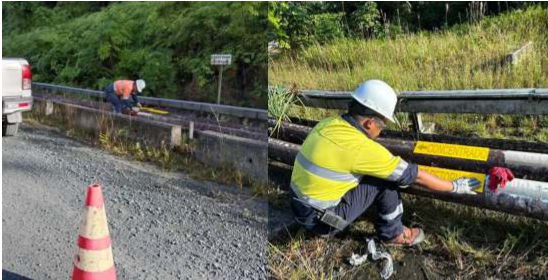
Ilustración 36 Verificación y etiquetado de línea de concentrado hacia puerto.
