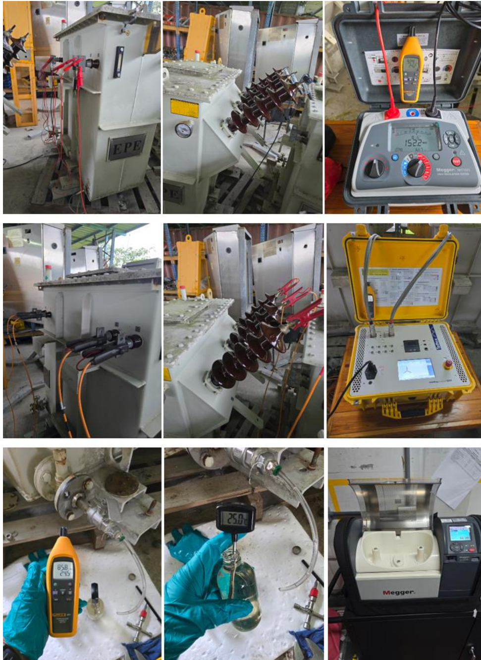
Imagen: Transformador EPE – 150kVA, 34.5/0.48kV, SN:61313076
