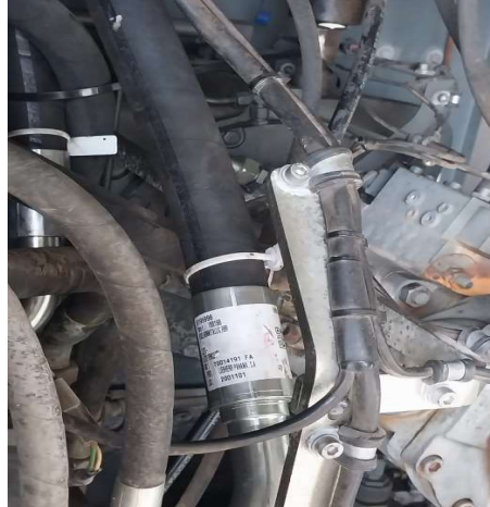
EXL004 – Cambio líneas de Bomba de giro
