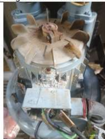
4. Blower no enciende.
