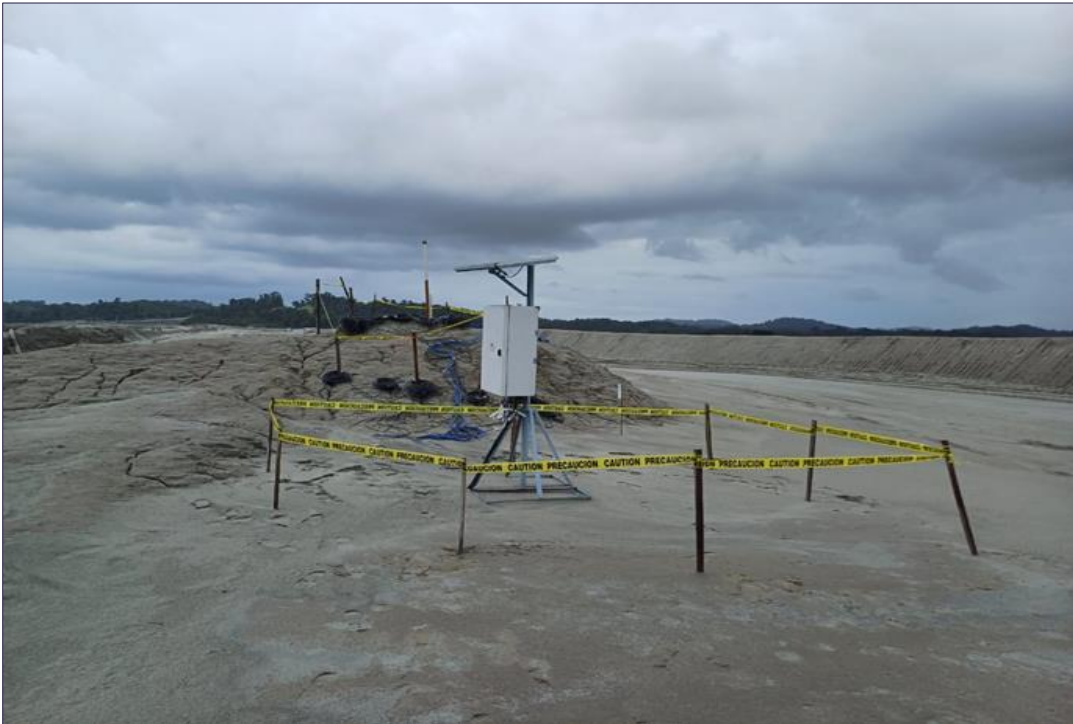
Figura 75 - Señalización y protección de instrumentación geotécnica Muro Norte
