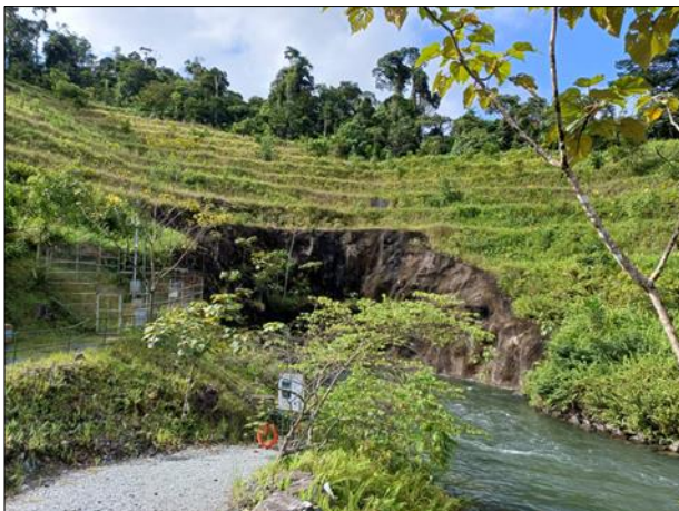
Figura 65 - Los taludes de la salida de descarga (túnel) se encuentra en buen estado
