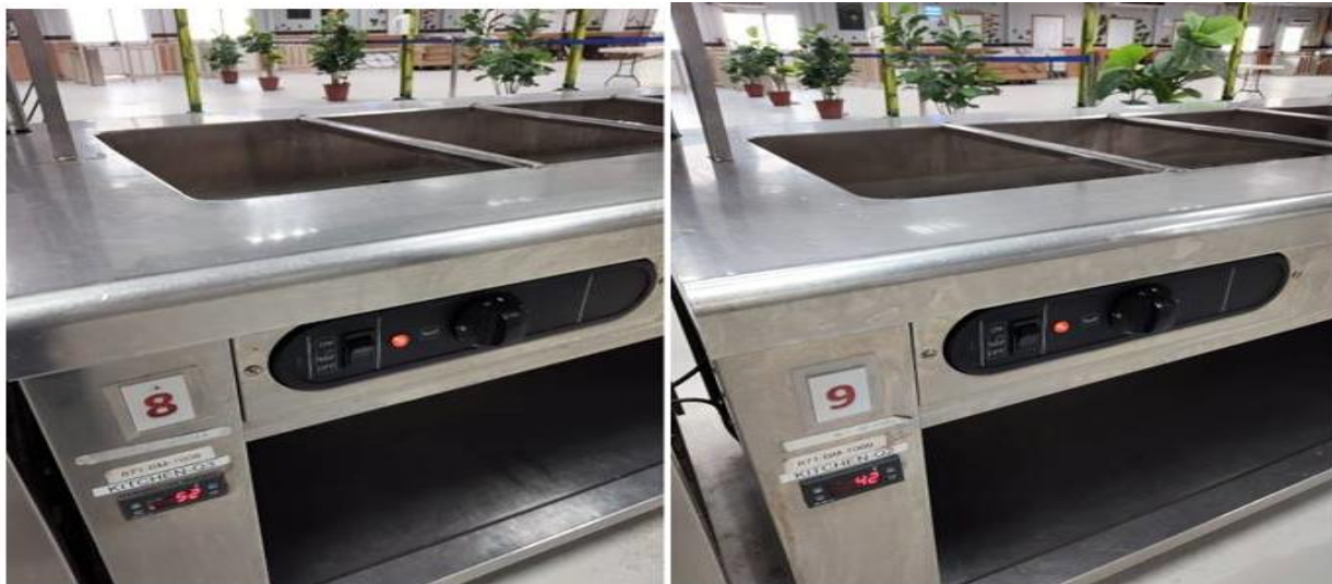
Reactivación de línea de comedor #3
