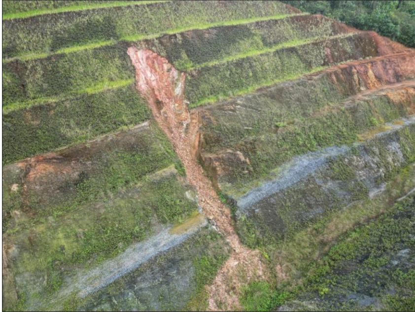
Figura 74 - Erosión en banquetas de canal 6 Muro Este, WRP6
