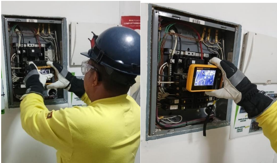
Termografía eléctrica de Panel de Distribución de habitación - Módulo C de Caribbean
