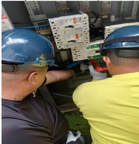
Inspección eléctrica de Panel de Distribución - Módulo C de Caribbean
