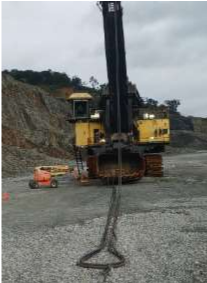
SHE01. Desmontaje de Cables de levante para reparación de transmisión de hoist
