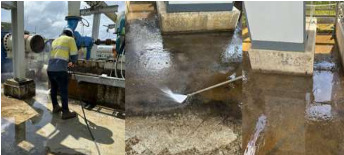
Ilustración 25 Limpieza de piso y estructuras con hidrolavadora (antes y después).
