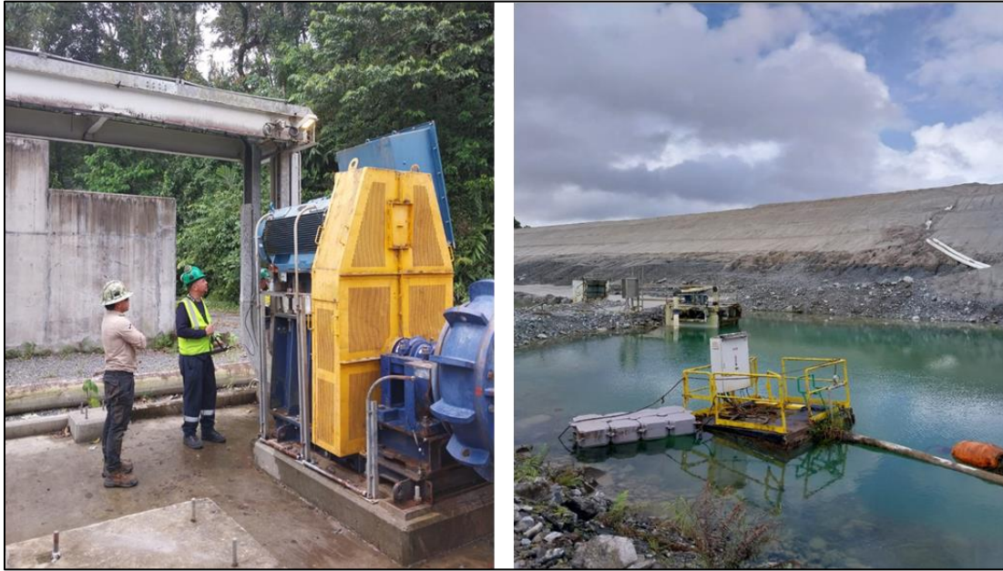
Figura 4 - Monitoreo de condiciones de bombas de las estaciones de recolección de filtraciones
