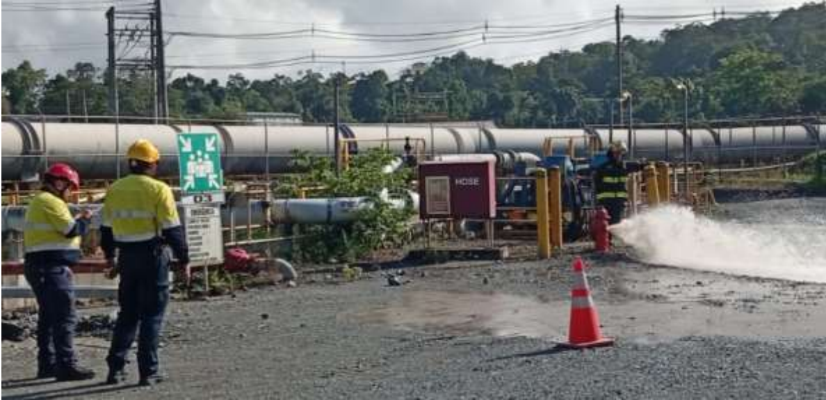
Ilustración 8 Prueba de capacidades en hidrantes de la planta de procesos.
