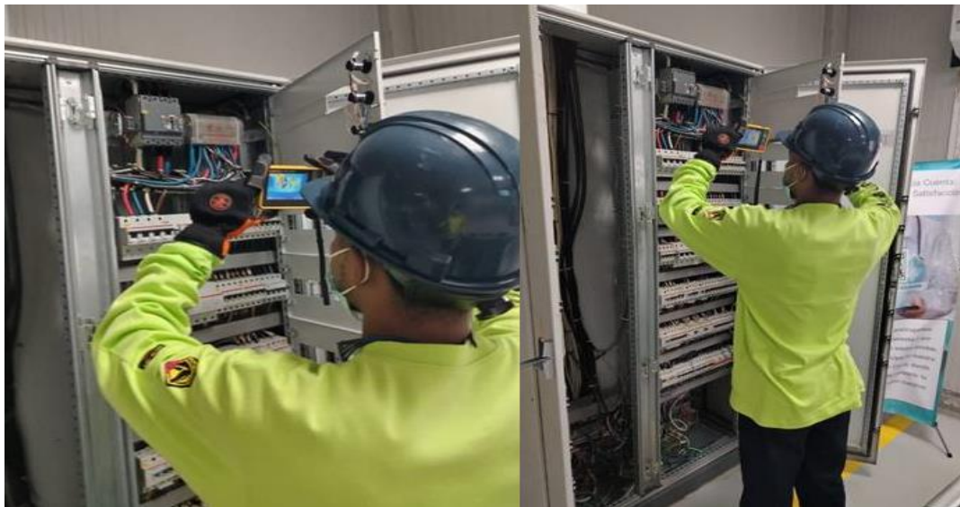
Temografía en Tableros de Distribución de Clínica Cobre
