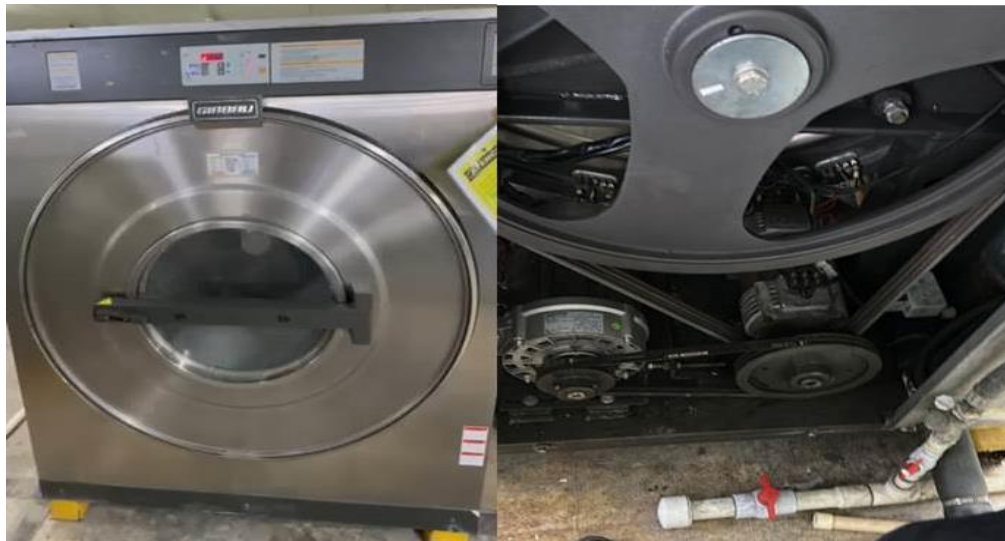
Reemplazo motor en Lavadora Girbau
