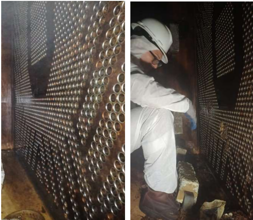
Inspección y limpieza de las caja de agua de mar A & B
