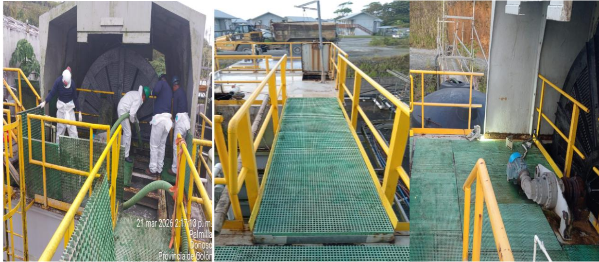
Limpezas en área de sedimentadores primarios y limpiezas de infraestructuras STP Caribe.
