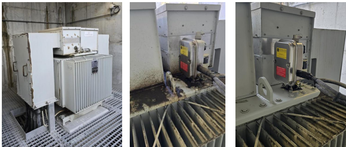
Imagen Transformador: 311-SUB-1001
