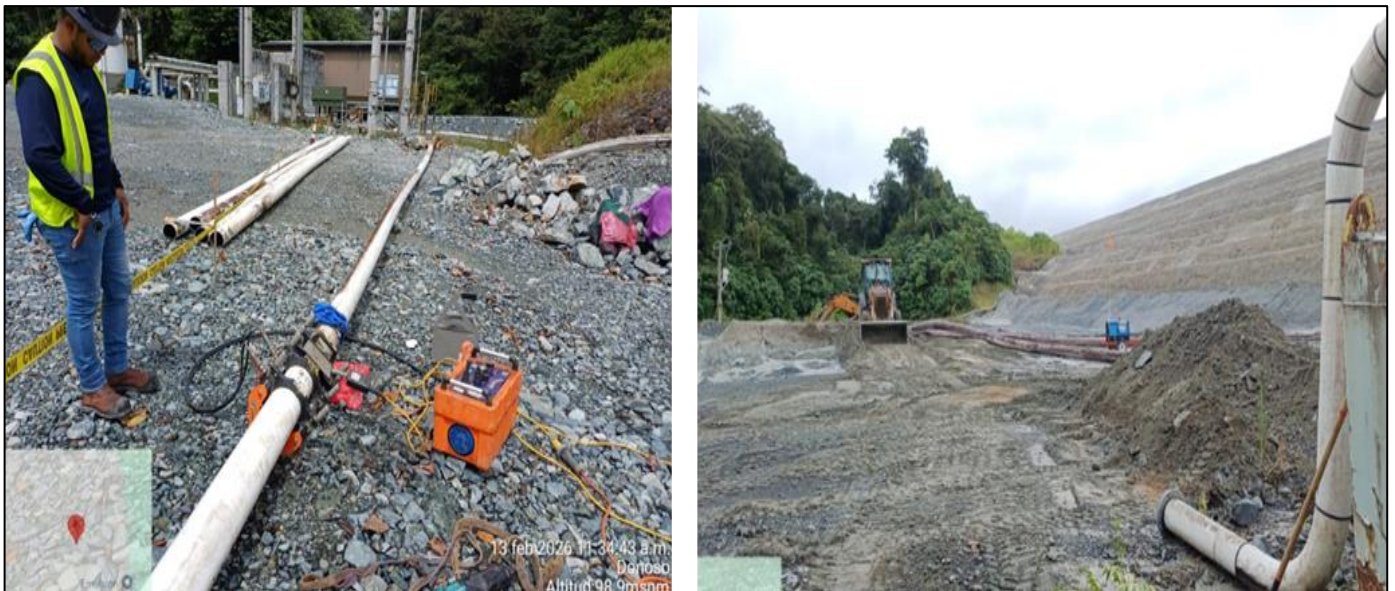
Figura 7 - Reubicación de tuberías de descarga de arena y tuberías de relaves para reparación de erosiones.
