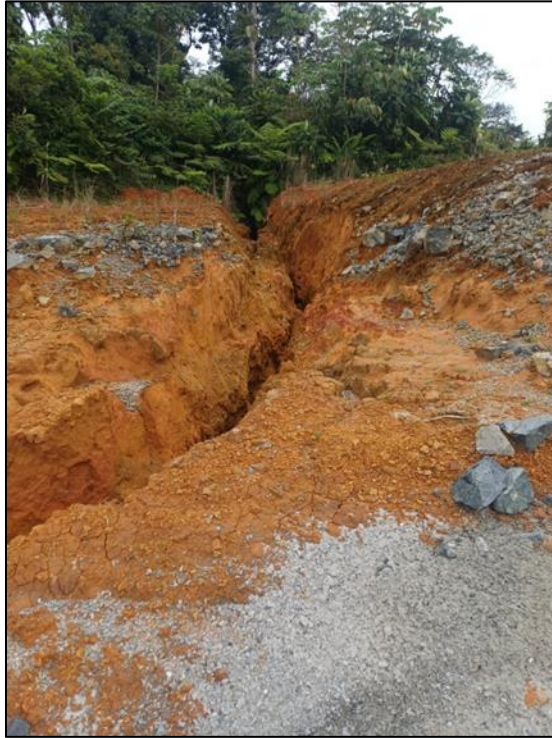
Figura 74 - Erosión en terreno natural, Celda 30 Muro Norte
