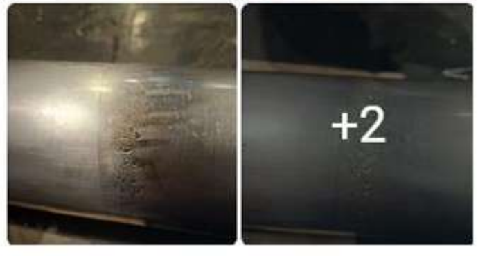
Foto N° 4 – Inspección Bearing dañado Desaladora D
