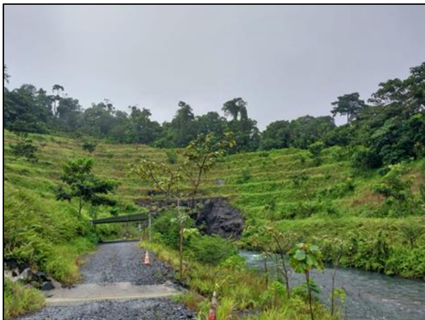
Figura 66 - Los taludes de la salida de descarga (túnel) se encuentra en buen estado
