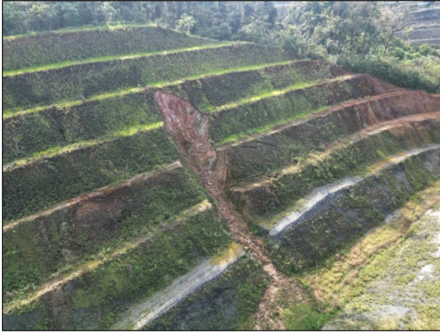
Figura 72 - Erosión en Canal 6
