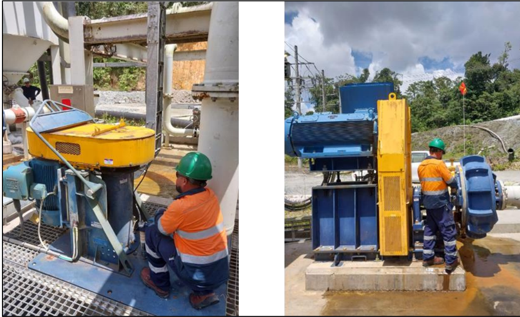
Figura 4 - Monitoreo de condiciones de bombas de las estaciones de recolección de filtraciones
