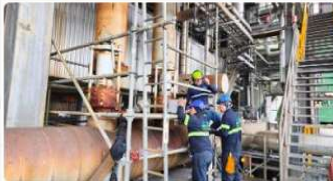
Foto N° 3 – Calibración Valvulas Seguridad Caldera U2
