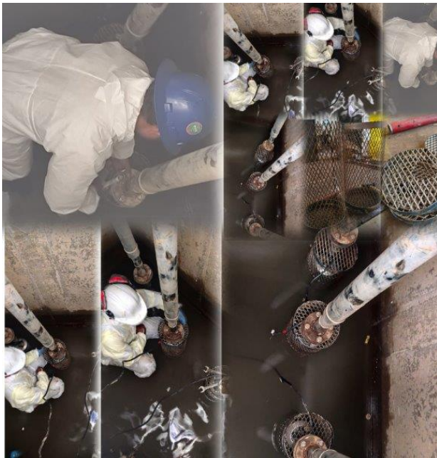
Limpieza rejillas en la succión de la bombas del sumidero de la GIS.
