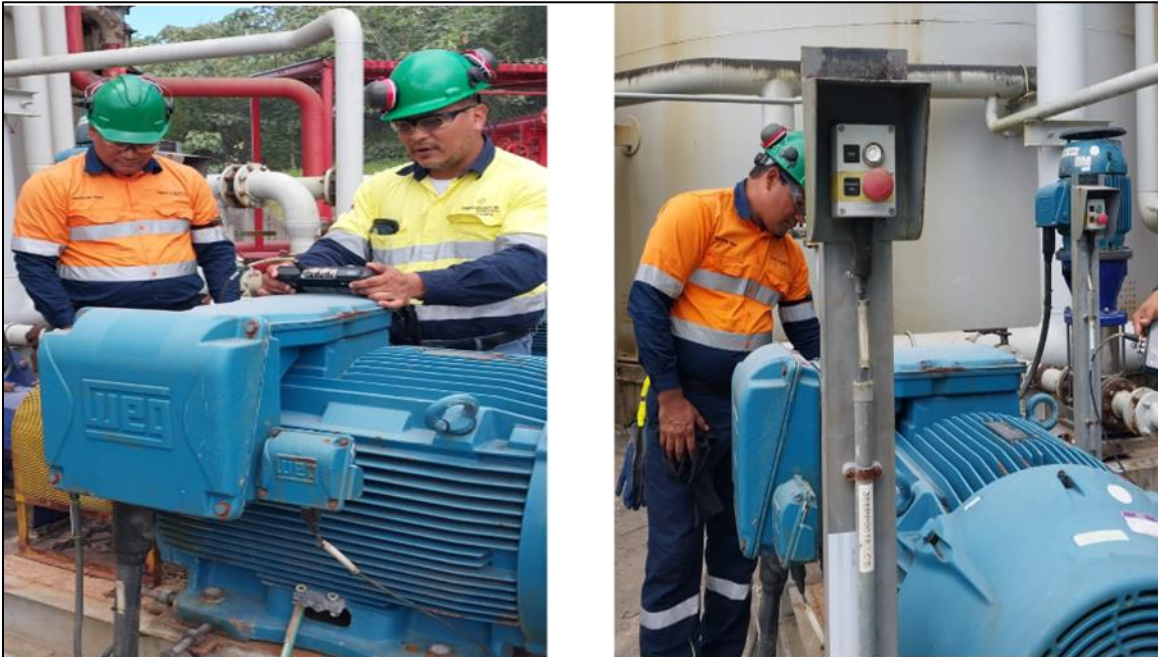
Figura 5 - Monitoreo de condiciones de bombas de las estaciones de recolección de filtraciones
