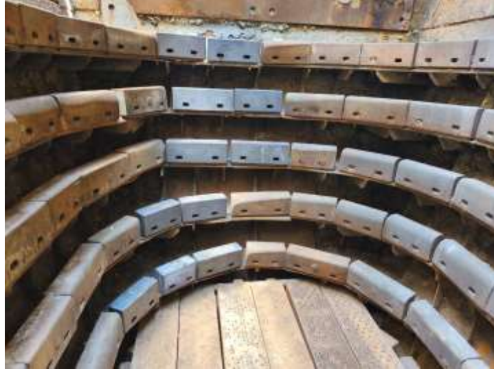
Ilustración 20 Instalación de nuevos revestimientos para dejar el chute disponible para el paso del material rocoso.
