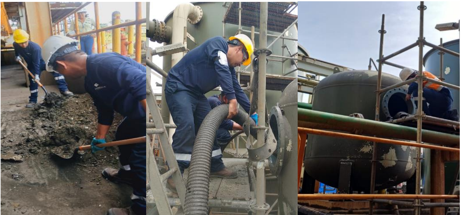
Limpieza e inspección del polishing filter
