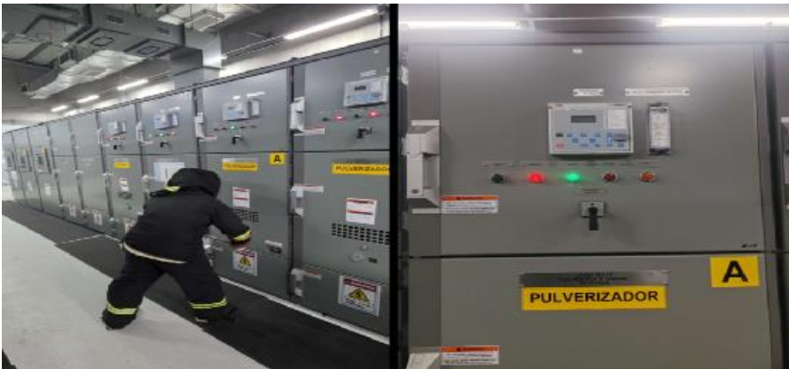
Mantenimiento en Switchgear MV 6.9 kV
