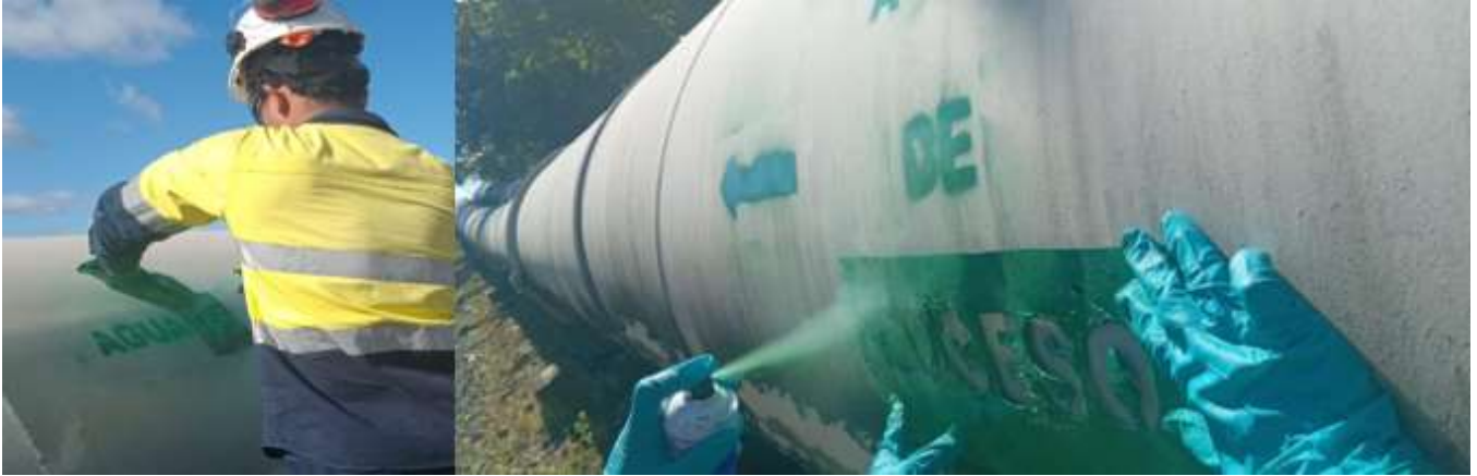
Ilustración 36 Demarcación de tuberías de agua de proceso.
