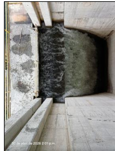
Figura 73 - No se observan obstrucciones en la entrada de la torre de aliviadero
