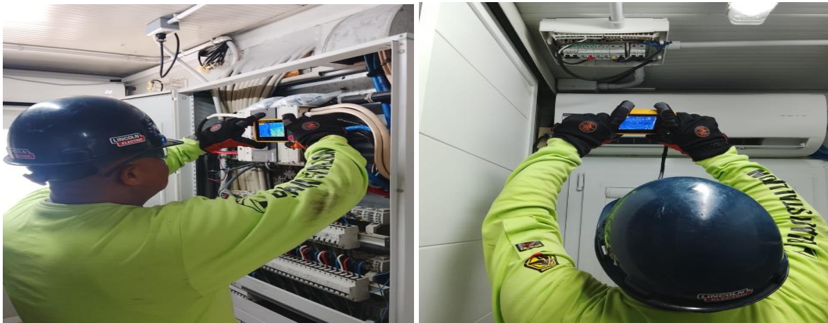
Termografía en Tableros de Distribución Módulo T1B Cobre
