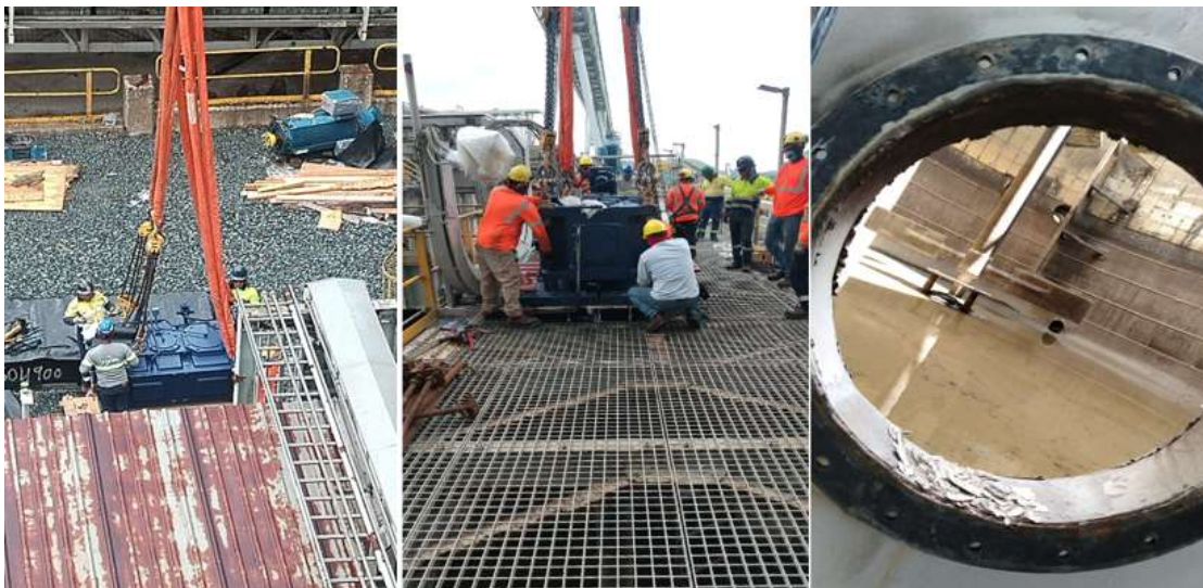
Ilustración 31 Inspección de trabajos críticos liderando el control y seguridad de los trabajos.
