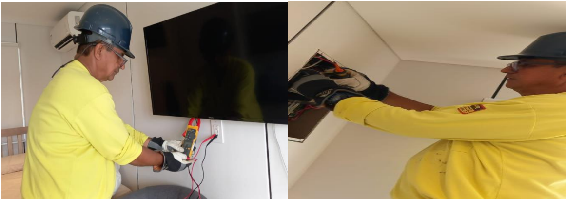
Inspección eléctrica de Habitaciones en Casas Nuevo Caribbean
