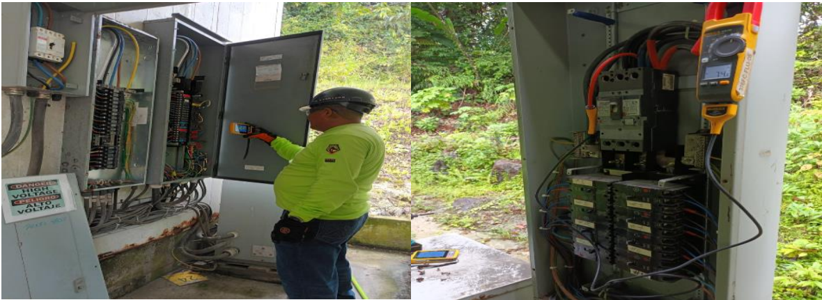
Termografía en Tableros de Distribución de Bodega de Alimentos Cobre
