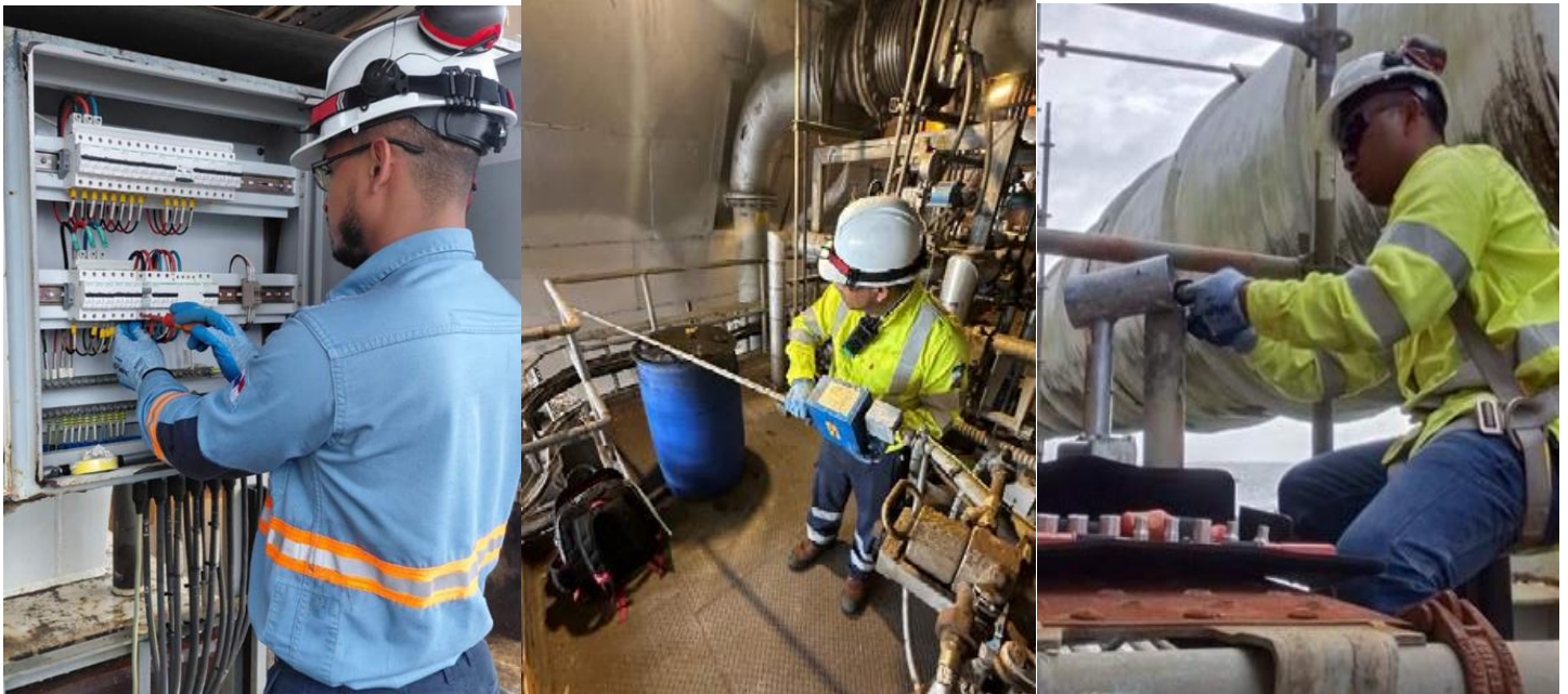
Técnico realizando inspección del equipo en sitio
