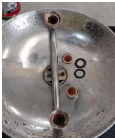
Ilustración 35 Limpieza y verificación de lavaojos.
