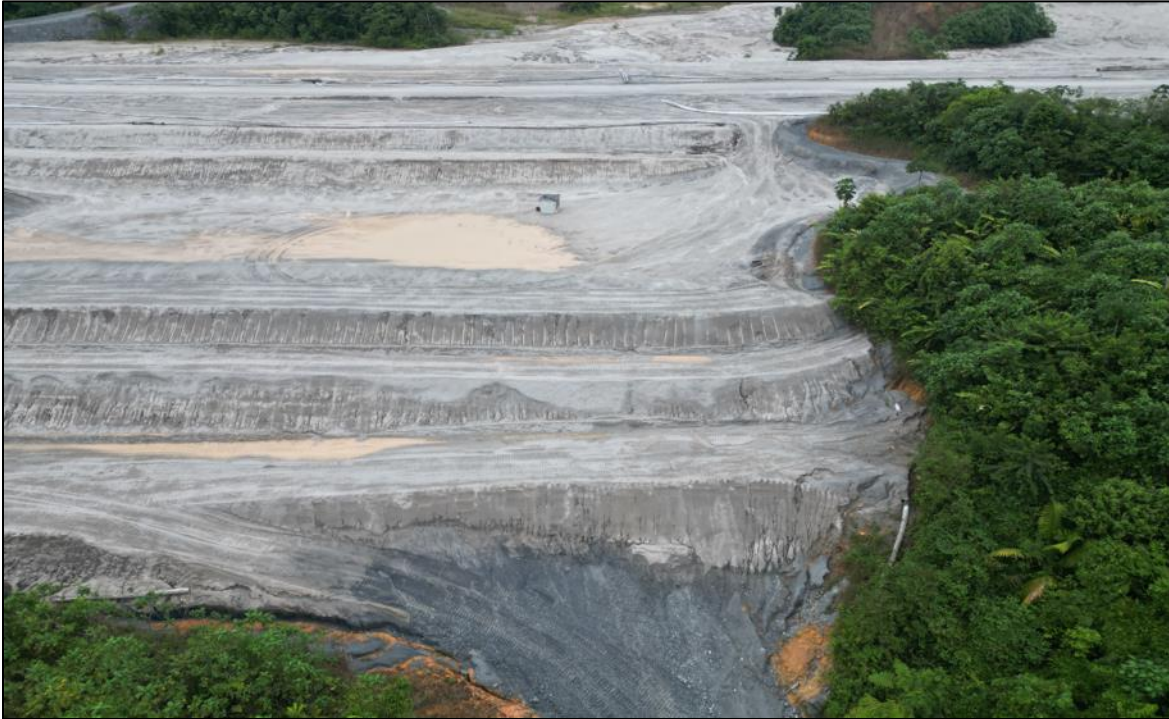
Figura 88 - Erosión en contorno de zona 3 y banquetas, Muro Este, Celda 14.
