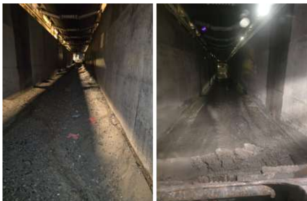
Ilustración 12 Remoción de sedimentos en túneles parte baja de las fajas (antes y después).
