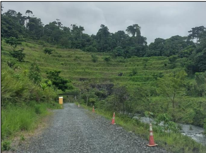
Figura 81 - Los taludes de la salida de descarga (túnel) se encuentra en buen estado
