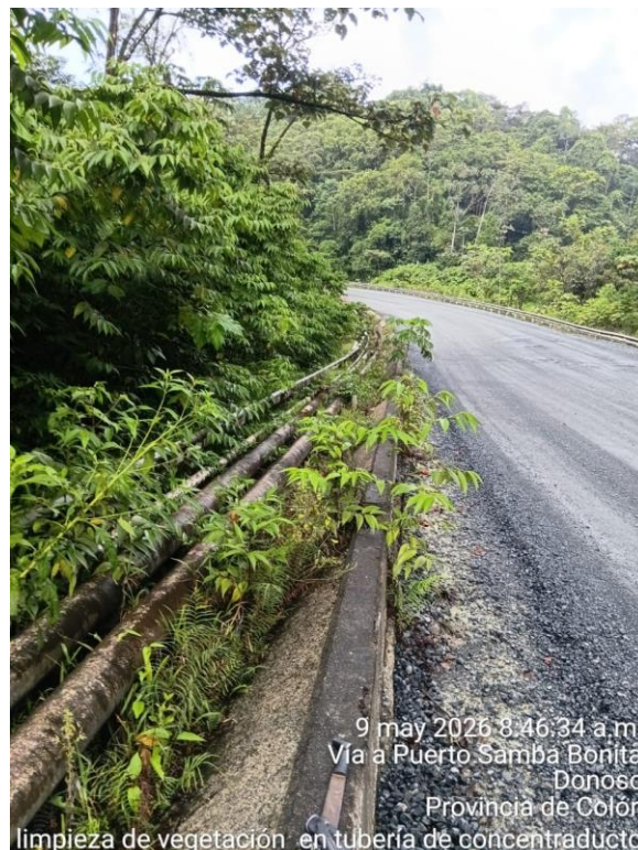
Fotografía 19. Registro antes de la limpieza en el mineroducto.
