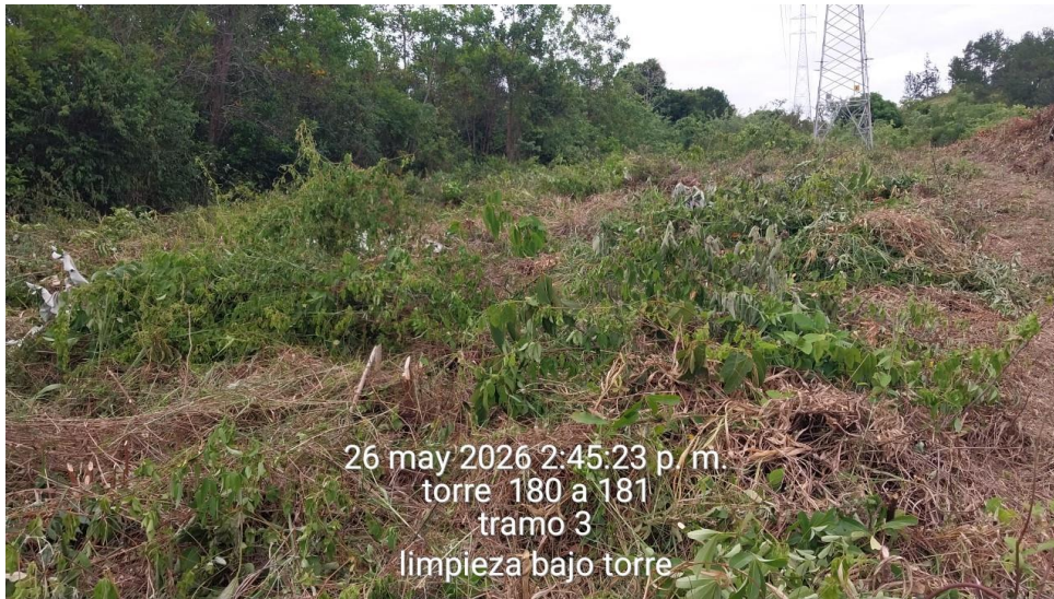
Fotografía 21. Evidencia de limpieza de vegetación bajo la servidumbre de la torre 180 del tramo II.
