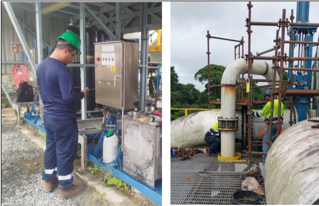
Figura 7 - Monitoreo de condiciones de bombas de las estaciones de recolección de filtraciones
