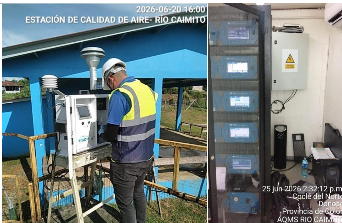
Fotografía 37. Mantenimiento e inspección de las estaciones de Calidad de Aire ubicada en San Benito y Río Caimito.
