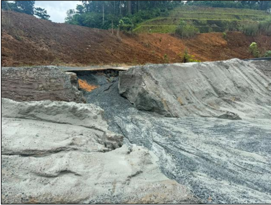
Figura 83 - Erosión en contorno de zona 3, Muro Este, Celda 12.
