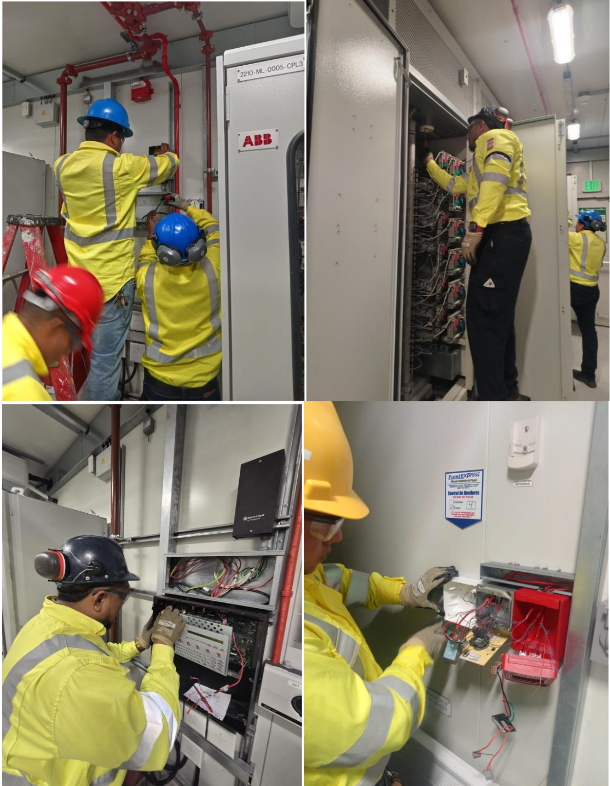
Actualización de Sistemas de protección contra Incendios E-house.
