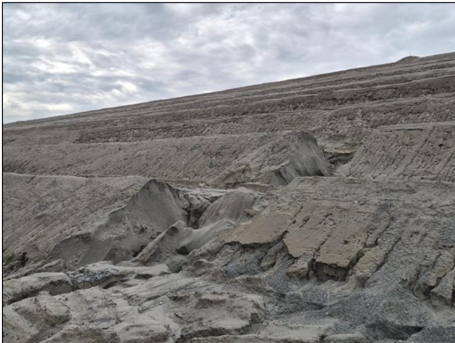
Figura 84 - Erosión en Banquetas, Muro Norte, Celda 10, Aguas Abajo.
