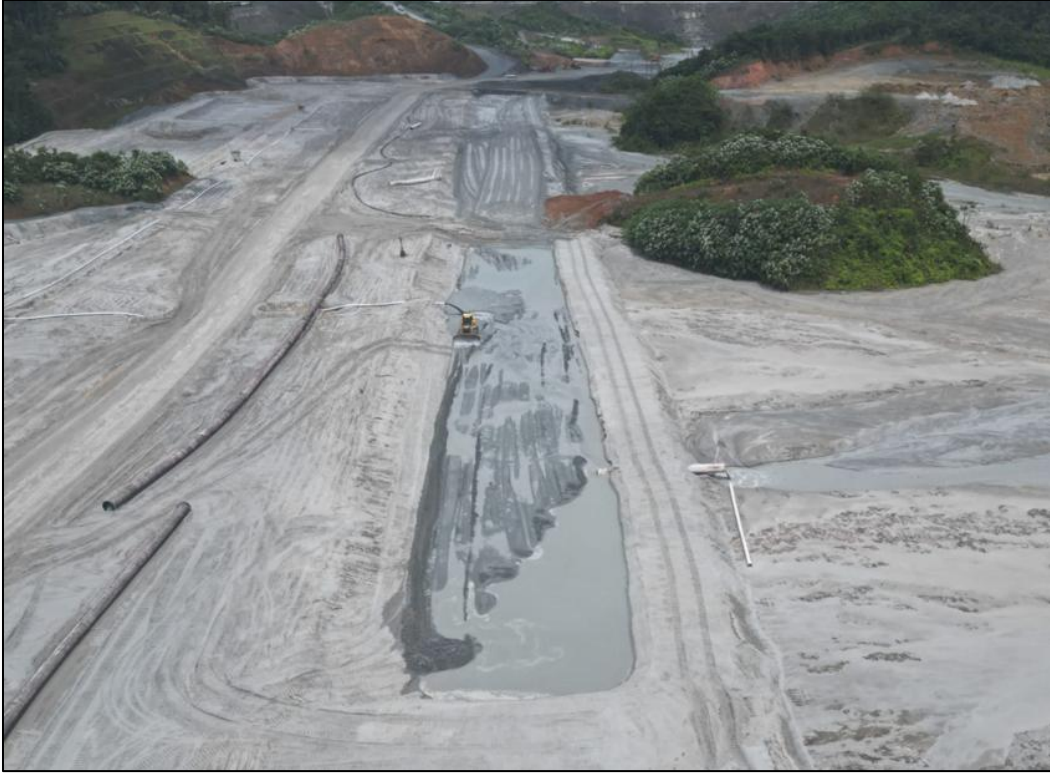
Figura 31 - Descarga hidráulica de arena cicloneada, Soporte WRP05, Muro Este
