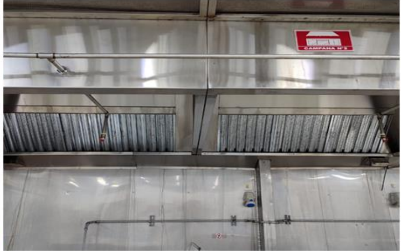
Limpieza de campanas de extracción
