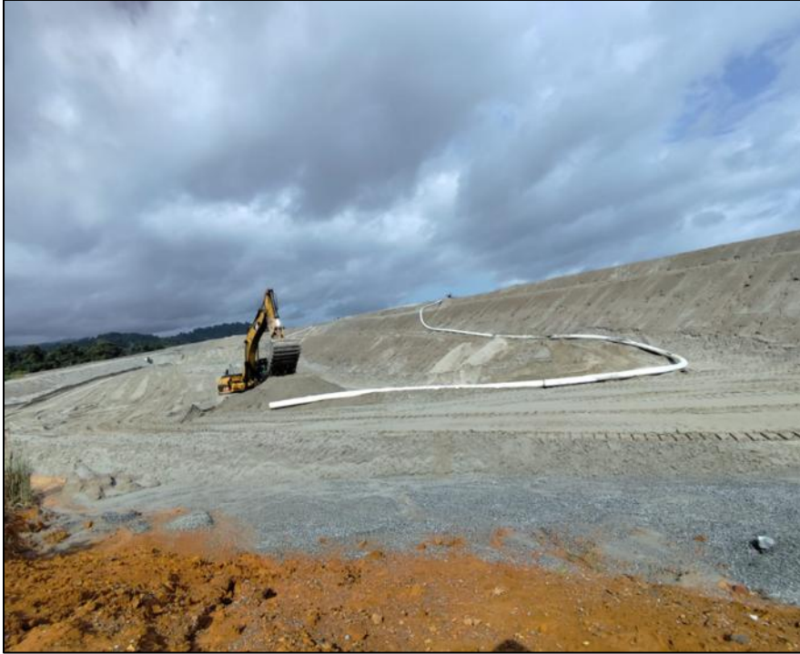
Figura 8 - Habilitación de Sistema de Descarga de Arena Cicloneada en celdas
