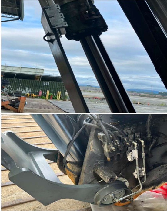
EXL-002. INSTALACION DE PROTECTORES DE CILINDROS DE BALDE.
