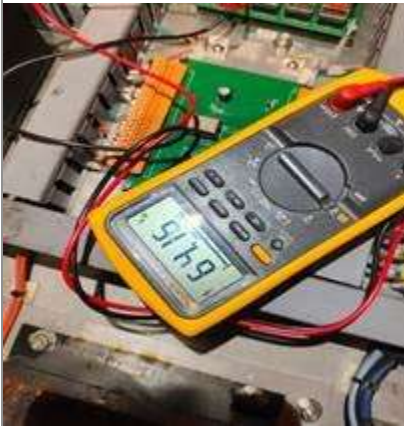
SHE-0000-001 Evaluación de falla de A/A Fan Condensador
