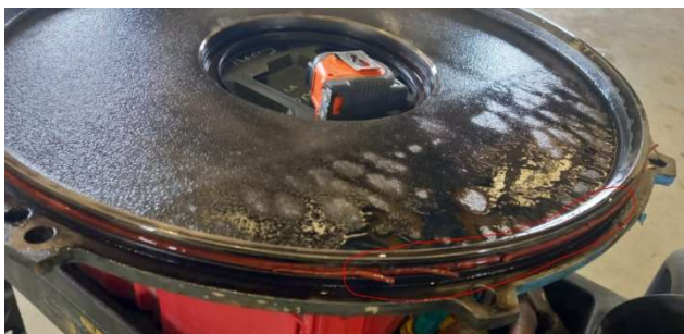
DTU004 Cambio de sellos de la tapa frontal del motor Diesel por fuga
