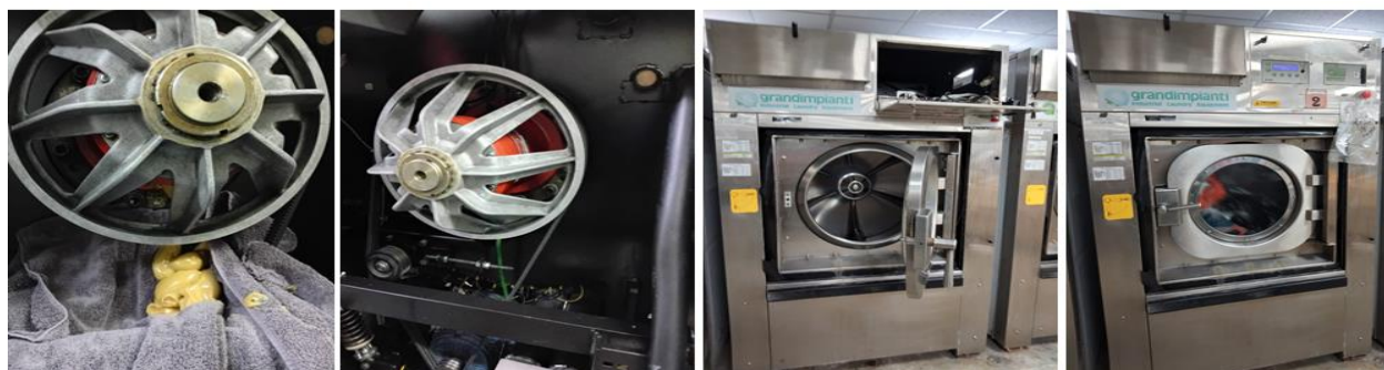
Mantenimiento Preventivo Lavadoras - Lavandería 2 Cobre
