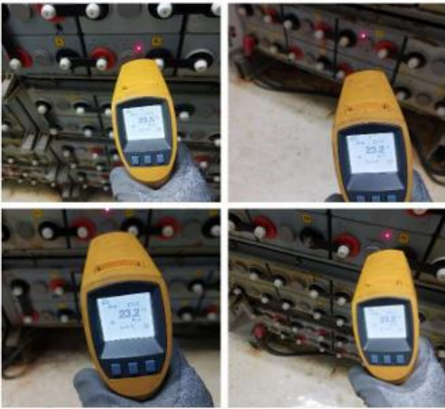
TEMPERATURA DE BATERIAS
