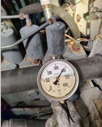
EXL-0000-106 Falla en PRV2 del BV1-1
