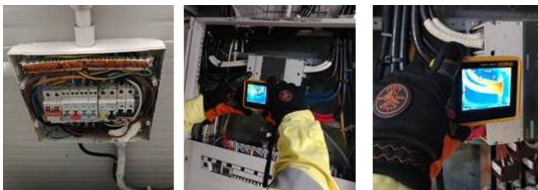
Termografía en Tableros de Distribución T2-X
