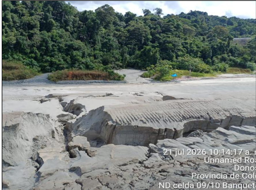
Figura 80 - Erosión en Banquetas, Muro Norte, Celda 09, Aguas Abajo.
