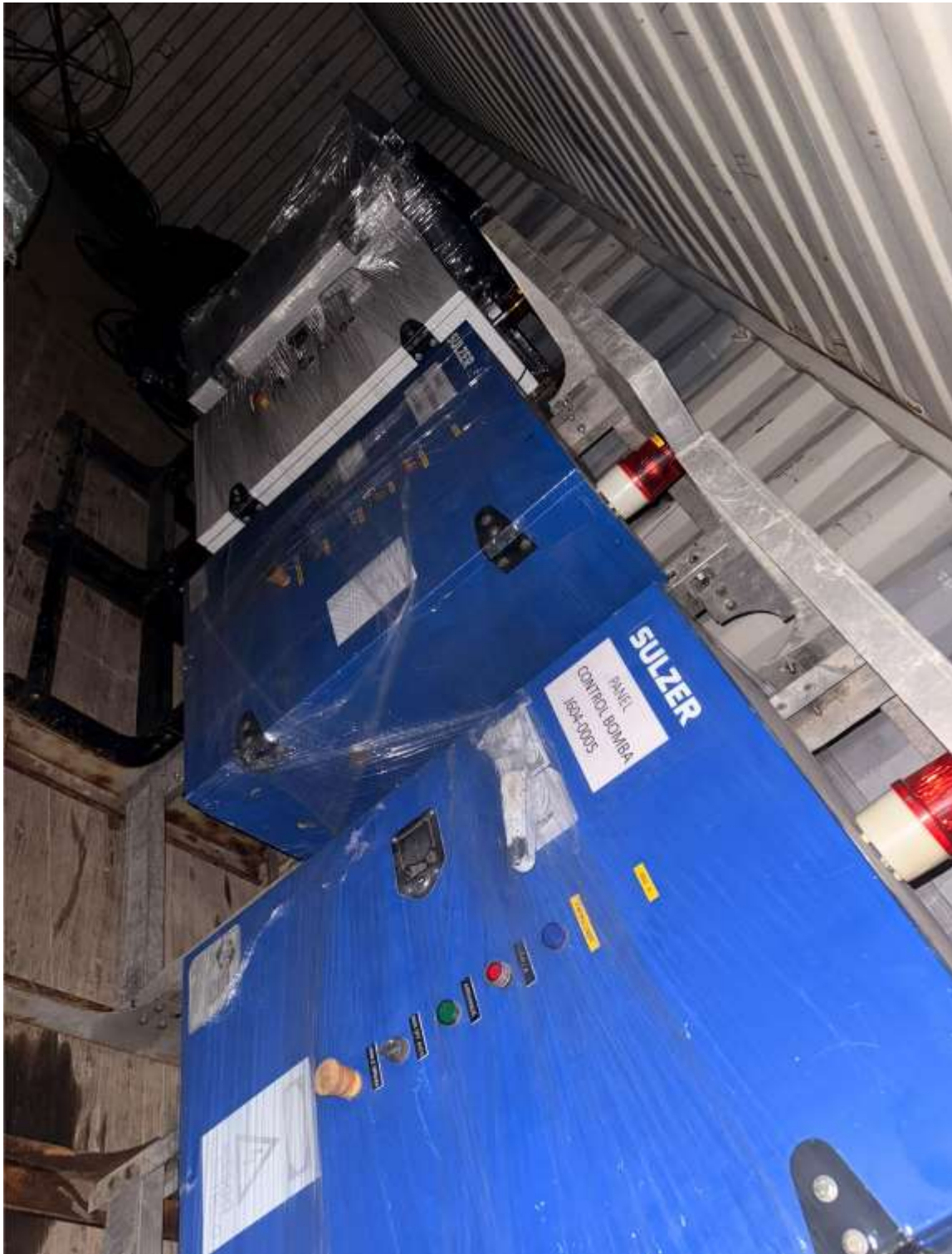
Caja de control para bombas j604
