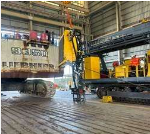
DRE-0000-106 Instalación de enfriador de aceite
