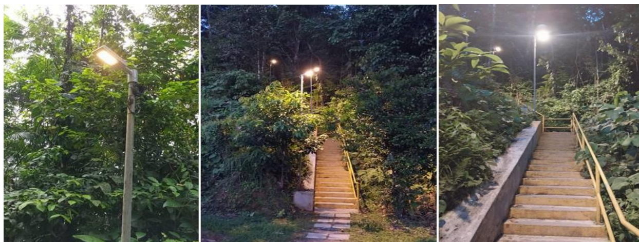
Inspección Eléctrica Alumbrado Nocturno
