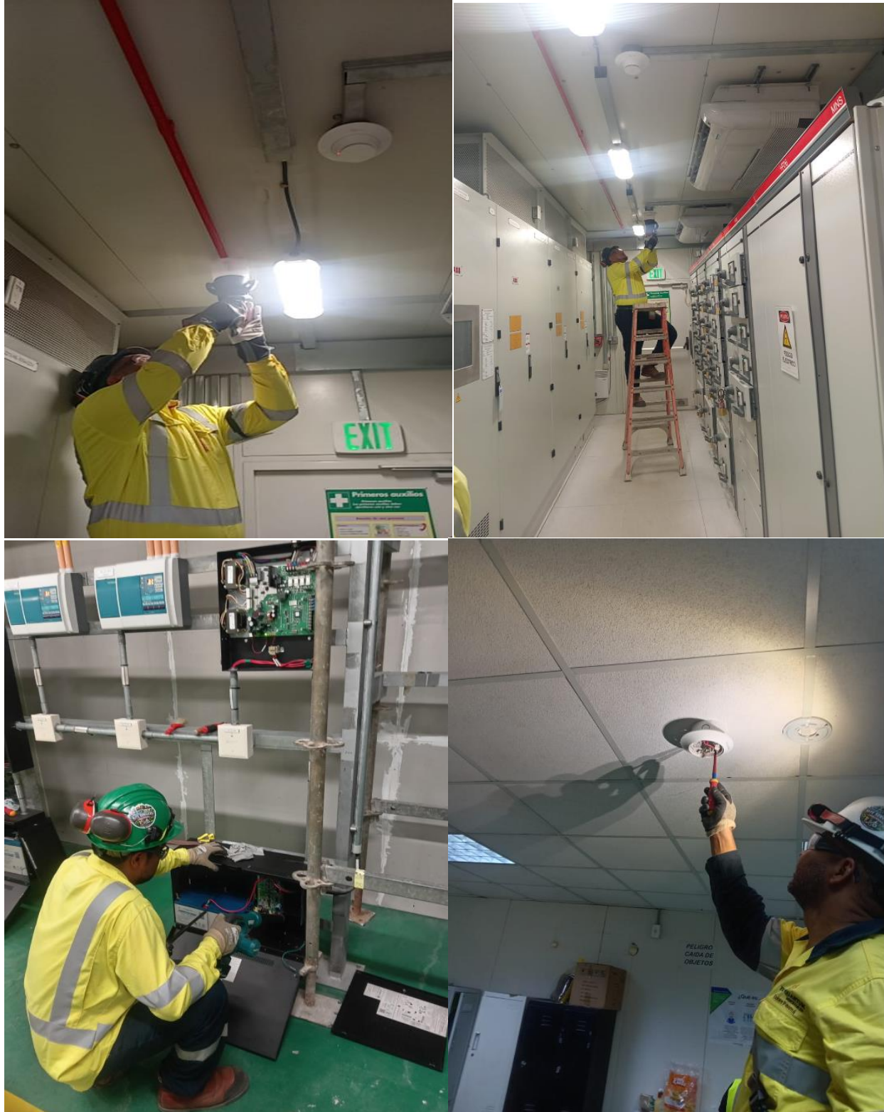
Sistemas contraincendios y Actualización de Sistemas de protección contra Incendios E-house.
