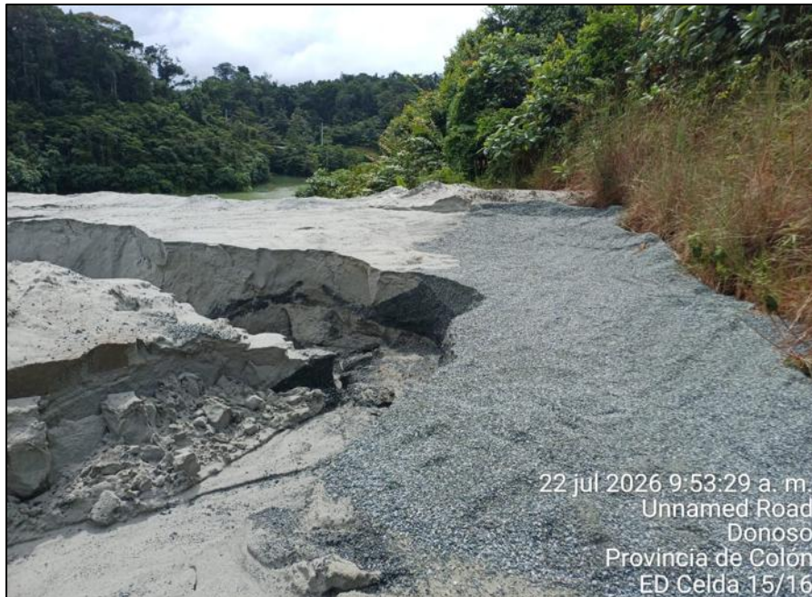
Figura 79 - Erosión en contorno de zona 3, Muro Este, Celda 15.
